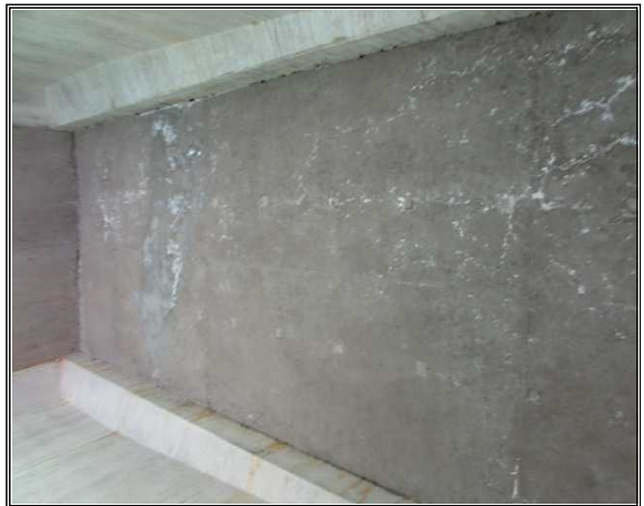
위 치 바닥판하면 S3 내 용 백태
