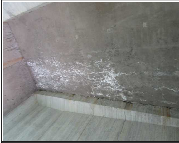
위 치 바닥판하면 S1 내 용 백태
