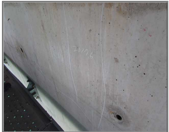
위 치 교각 P1 코핑 내 용 균열(CW : 0.3mm미만)
