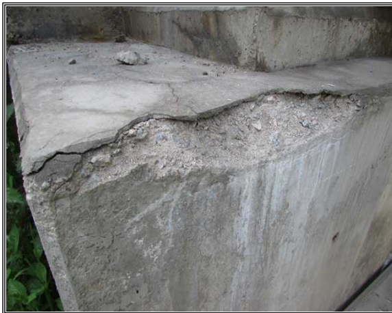
위 치 교대 A1 구체 내 용 박락
