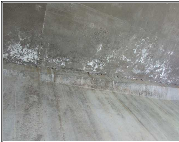
위 치 바닥판하면 S2 내 용 백태
