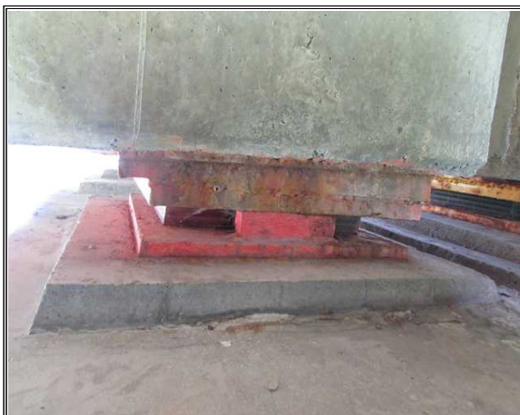
위 치 교각 P2SH1(A1) 내 용 플레이트 부식
