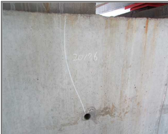
위 치 교각 P2 코핑 내 용 균열(CW : 0.3mm미만)
