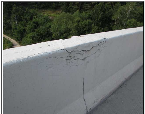
위 치 방호벽 S3 내 용 박락
