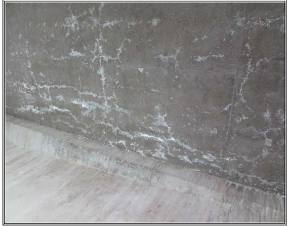
위 치 바닥판하면 S2 내 용 백태
