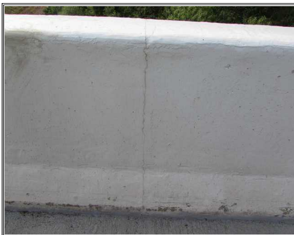
위 치 방호벽 S4 내 용 균열(CW : 0.3mm미만)
