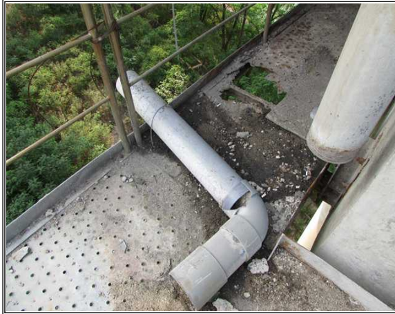
위 치 교각 P2 내 용 점검시설 부식
