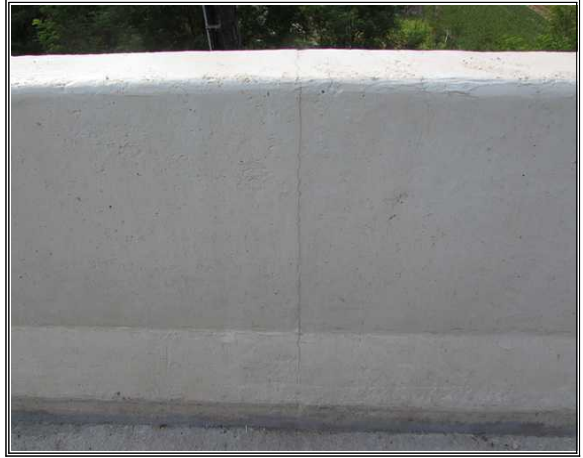
위 치 방호벽 S1 내 용 균열(CW : 0.3mm미만)
