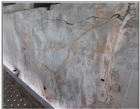
위 치 교각 P2 코핑 내 용 들뜸
