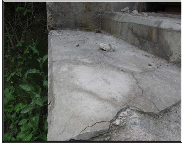
위 치 교대 A1 구체 내 용 들뜸
