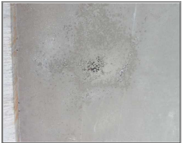
위 치 바닥판하면 S4 내 용 재료분리
