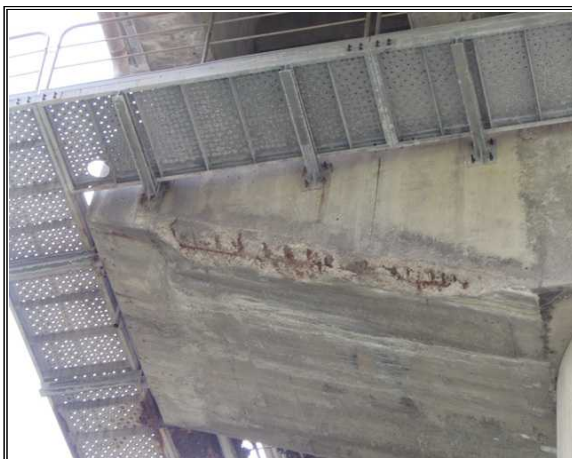
위 치 교각 P2 코핑 내 용 박락 및 철근노출
