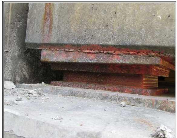
위 치 교대 A1SH1 내 용 플레이트 부식
