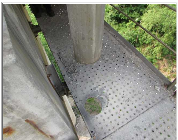
위 치 배수시설 P2 내 용 배수관 길이부족
