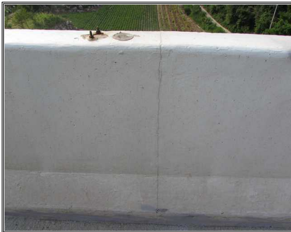
위 치 방호벽 S2 내 용 균열(CW : 0.3mm미만)
