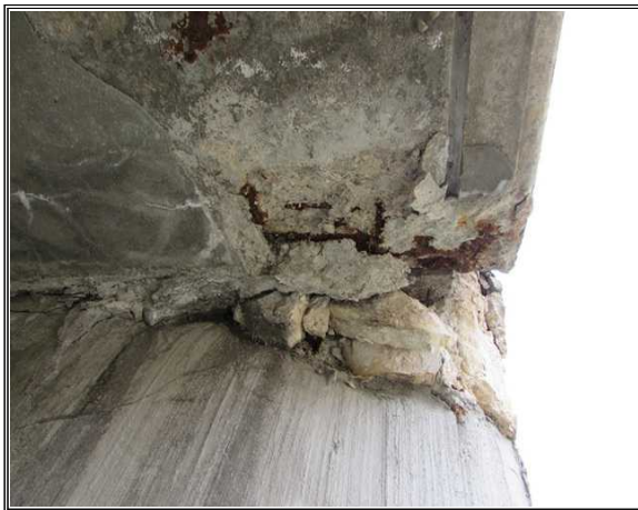
위 치 바닥판하면 S4 내 용 박락 및 철근노출
