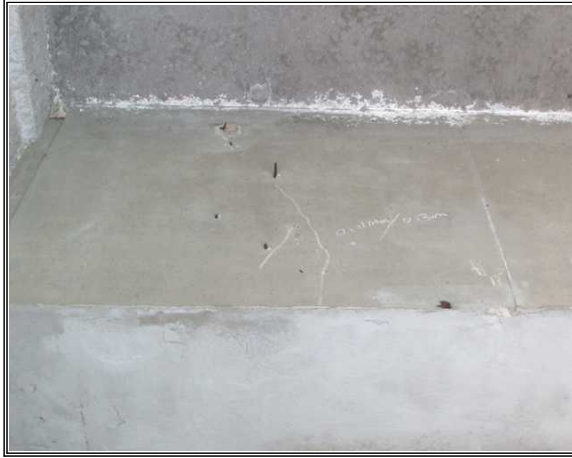
위 치 가로보 S4 내 용 균열(0.3mm미만)
